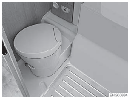
Bild 156 Toalettstol, vriden mot väggen
