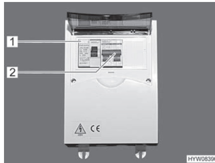
Afb. 119 230-V-zekeringenkast met beveiligingsautomaat en FI-schakelaar
