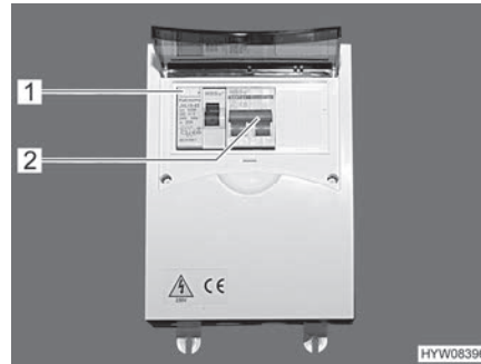
Fig. 119 Scatola dei fusibili a 230 V con interruttore di sicurezza e interruttore automatico FI
