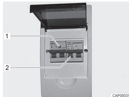
Fig. 92 Coffret de fusibles 230 V avec disjoncteur de protection de circuit et disjoncteur FI
