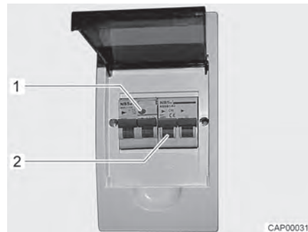
Kuva 90 230 V:n sulakerasia ja johdinsuojakytin sekä FI-kytkin
