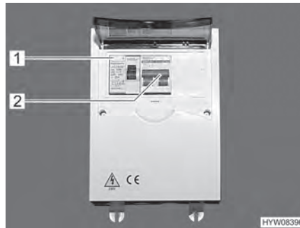
Bild 119 230-V-Sicherungskasten mit Leitungsschutzschalter und FI-Schalter
