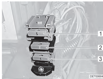
Bild 110 Sicherungen neben Elektroblock (Stellantis)
