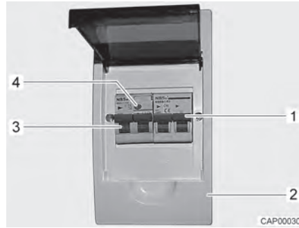
Bild 80 Leitungsschutzschalter und FI-Schalter (230-V-Sicherungskasten)
