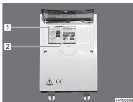
Bilde 119 230 V-sikringsboks med ledningsbeskyttelsesbryter og FI-bryter
